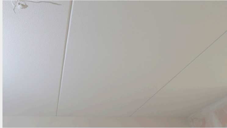
Spuitwerk op het plafond met zichtbare V-naden.
